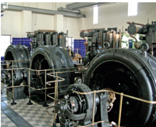
Dieselaggregate im Krafthaus
